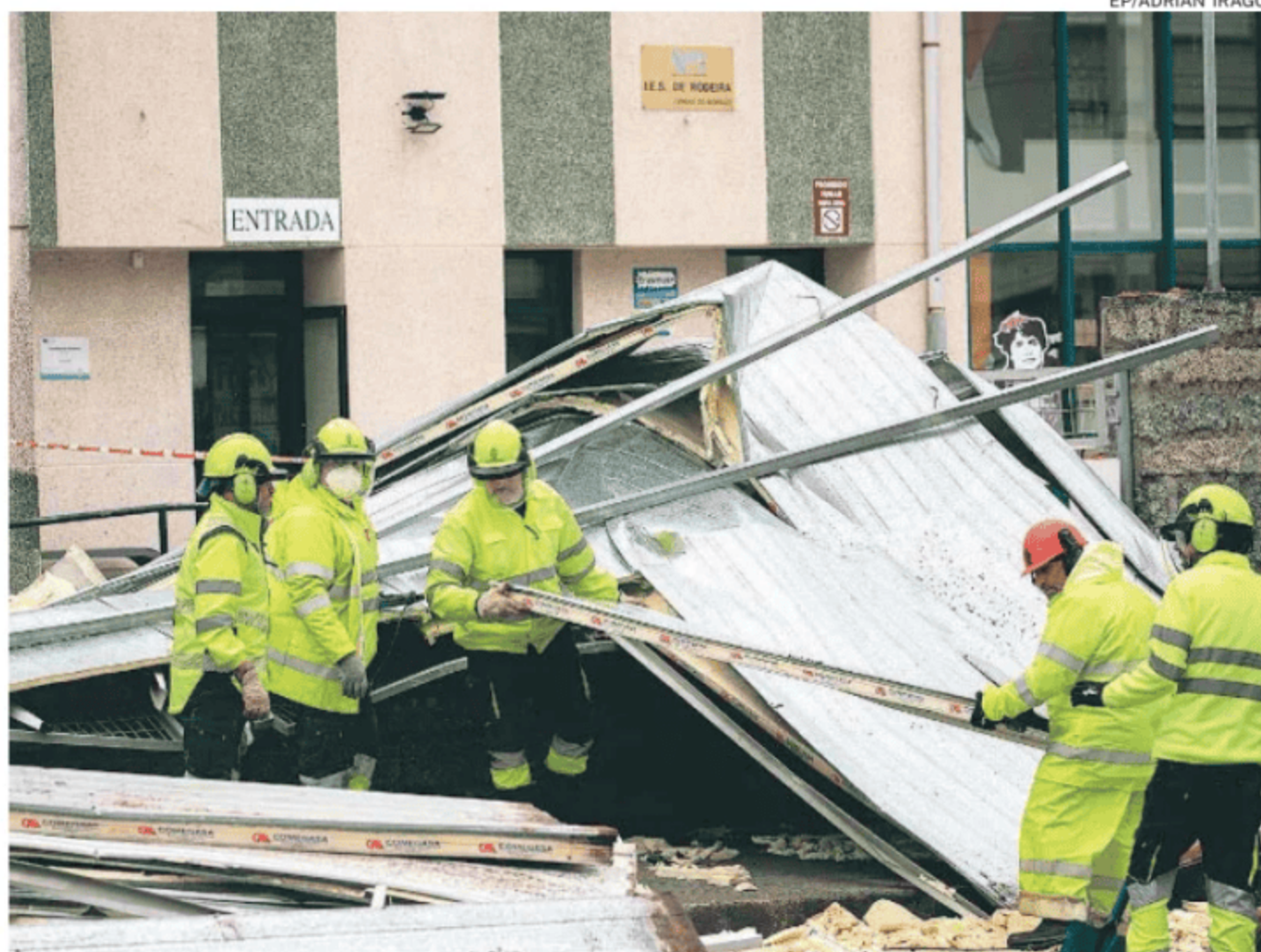
Los bomberos trabajan en el instituto IES Rodeira en Cangas (Pontevedra)
